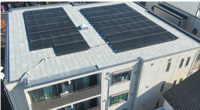
屋上に設置した太陽光発電システムで発電した電気を住戸に供給
